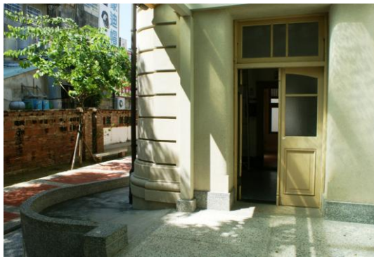
圖 6 銜接無障礙坡道的入口只開半邊門，寬度不足 80 公分，輪椅無法進入 資料來源：作者拍攝，2012 年 6 月
